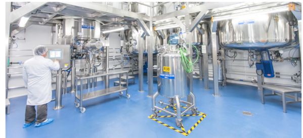
Implantación de la ISO 50.001:2011 e instalación de sistema de monitorización (Rovi)
